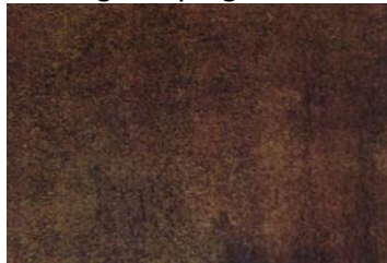
Nivå C godt synlig rust
