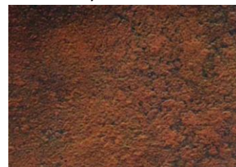
Nivå D mye rust
